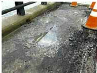
写真-1 床版正面損傷状況
