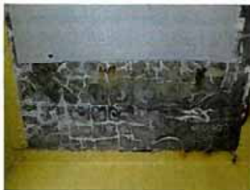
写真-2 床版下面損傷状況
